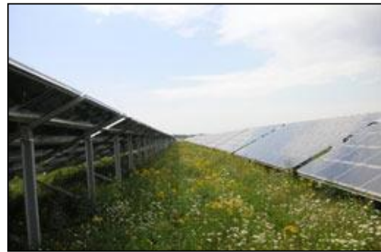
Abb.14: Beispiel für aufgeständertes Modulfeld
