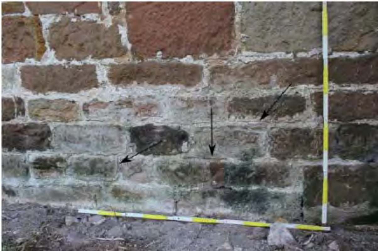
Chor, Nordwand. Ritzfugen in den unteren sechs Steinlagen (Pfeile zeigen exemplarische Lagen), 03.2014
