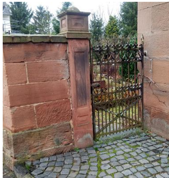
Sandstein-Mauerwerk, Pfeiler und Gartentür vor Haus Nr.5. Alles zusammen bildet als kleines Ensemble ein Schmuckstück dieses Grundstücks
