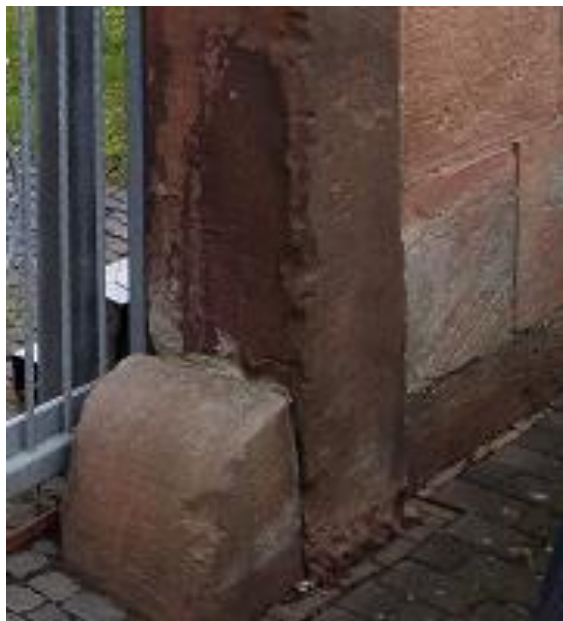
Torpfeiler mit Prellstein vor Haus Nr.4, Hauptstraße, mit Spuren der Beschädigungen durch Fahrzeuge
