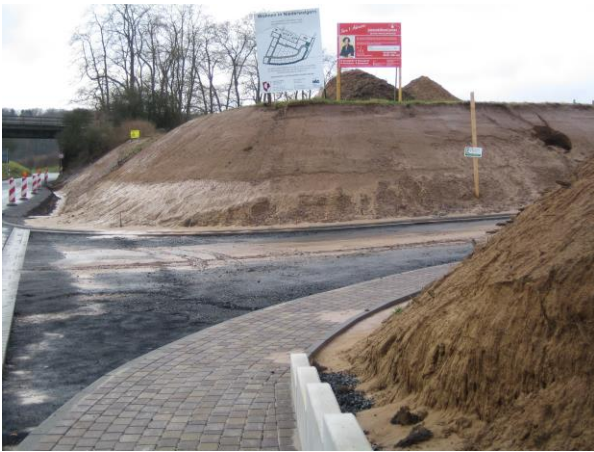
Abb. 5: Neu angelegte Zufahrtstraße zum Niederwälgler Neubaugebiet Große Hohl mit Abschwemmungen nach stärkerem Regen (Foto: Gerhardt 2008).
