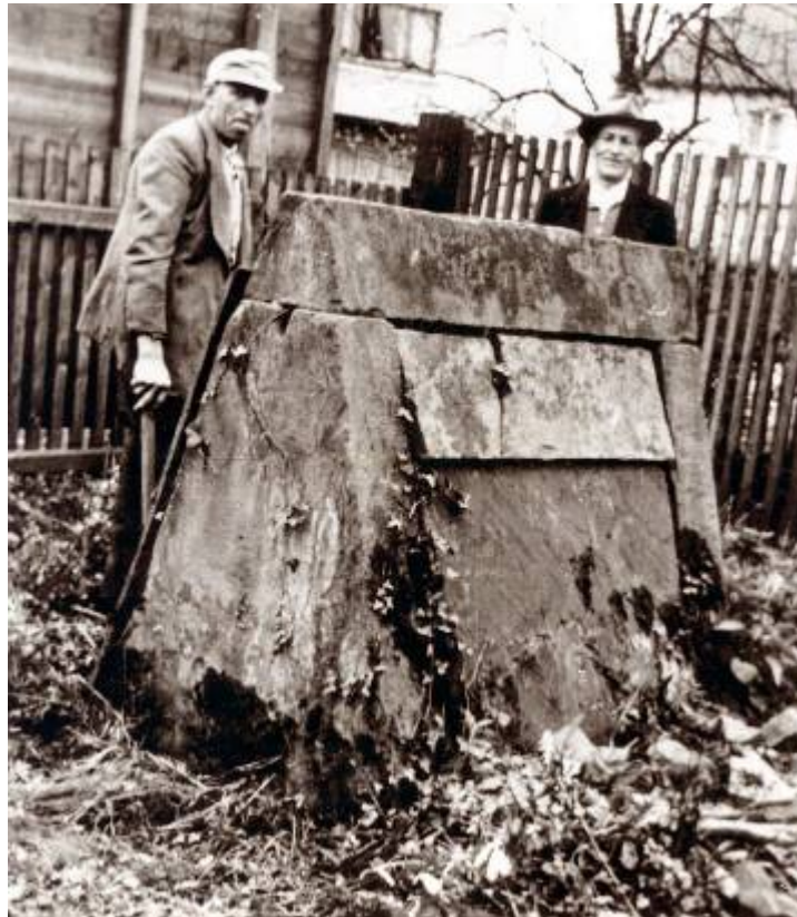
Alt-Bürgermeister Gerlach und Karl Hartmann bei den Abbrucharbeiten am alten Ziehbrunnen an der Schule in Niederweimar
